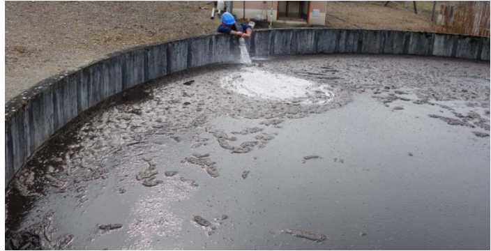
Figure 36 : Chaulage des boues du silo de Meyronne-Creysse.
