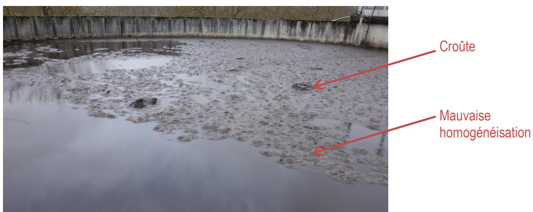
Figure 3 : Boues du silo de stockage pendant chaulage
