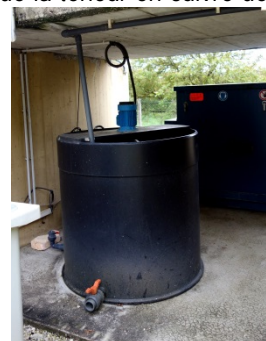
Figure 11 : Silo pilote mis en place à la STEU de Meyronne-Creysse.
