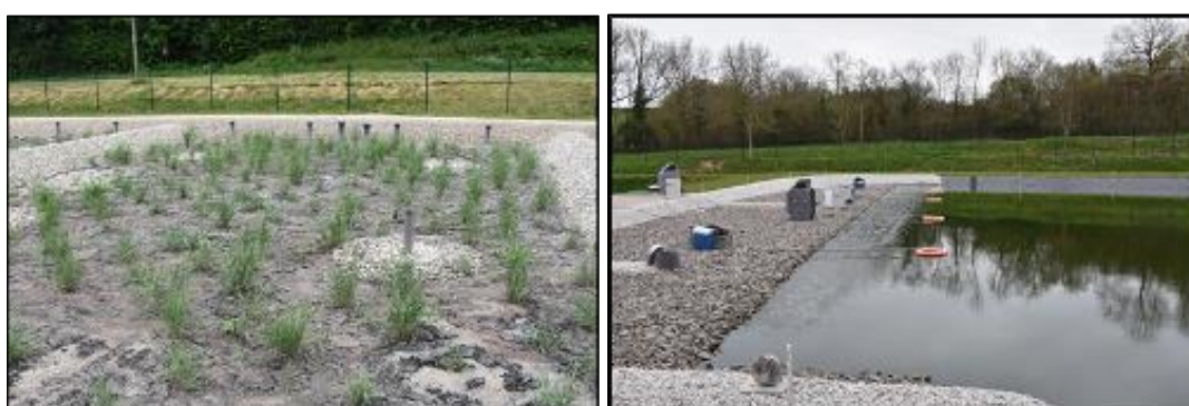
Figure 3: Photos du Biho-filtre® (à gauche) et de la lagune avec le rock filter aéré (à droite)
