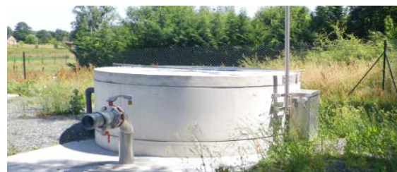
Décanteur-digesteur avec prise de boues pour vidangeur
