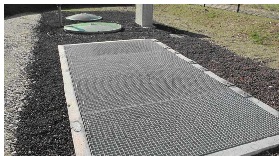
Dessableur statique à nettoyage manuel
