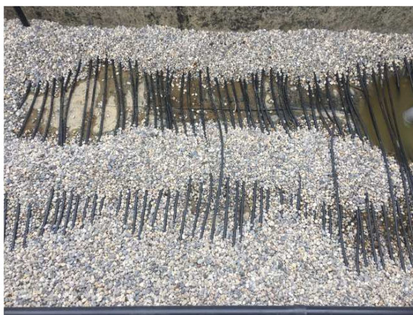
Figure 3. Photo du réseau d'aération en fond du filtre (©INRAE)
