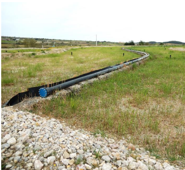
Filtre C : Station de Puisserguier. Filtre à écoulement horizontal planté de roseaux
