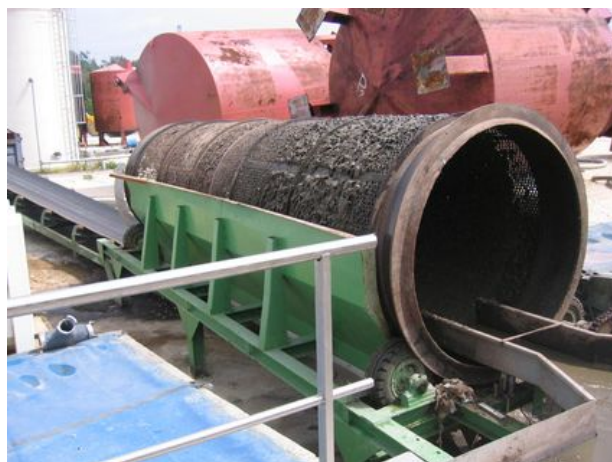
Photo 10 : Trommel du prétraitement (CTMA)
