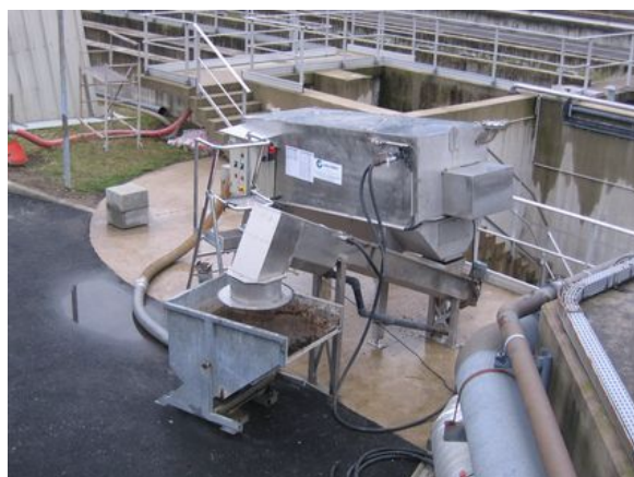
Photo 4 : poste prétraitement spécifique des matières de vidange
